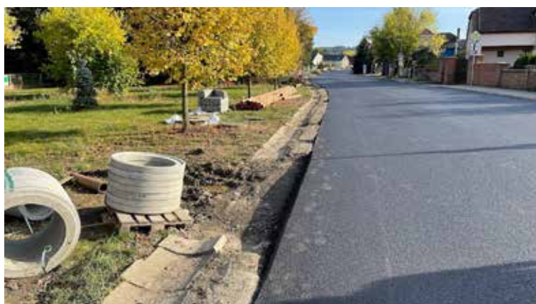
▲ Kolomuty, oprava povrchu komunikace po stavbě kanalizace
