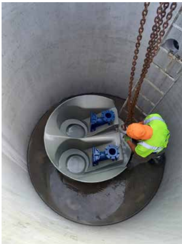
▲ Horní Stakory, hlavní ČS odpadních vod
