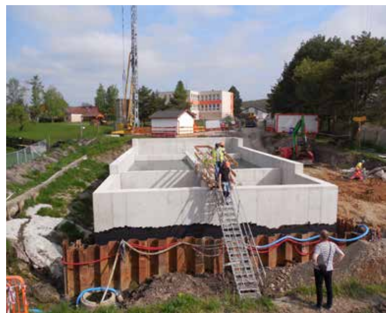
▲ Semčice, nádrže nové biologické linky ČOV
