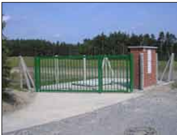
▲ Bělá p. Bezdězem, čerpací stanice odpadních vod Šestidomí
