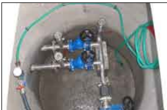
▲ Kosmonosy, armaturní šachta čerpací stanice
