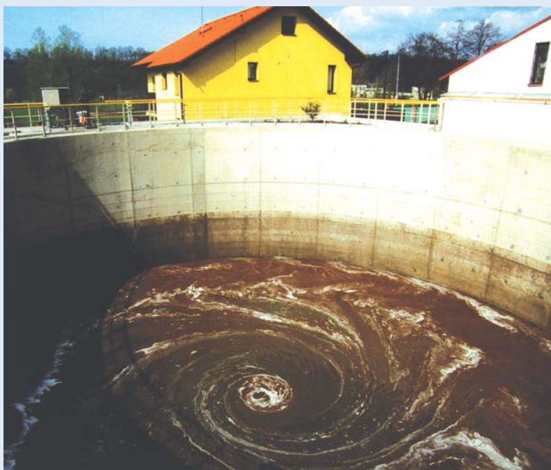
Vírový separátor na přítokové štole před ČOV II Mladá Boleslav
