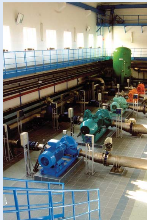
Čerpací stanice ÚV Rečkov
