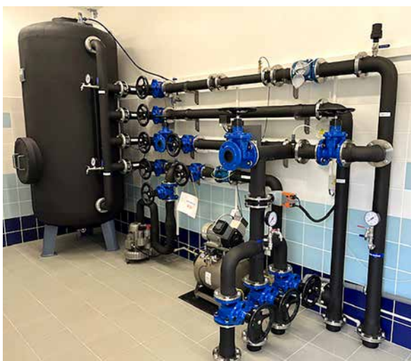
▲ Sobětuchy, pohled do technologie úpravy vody
