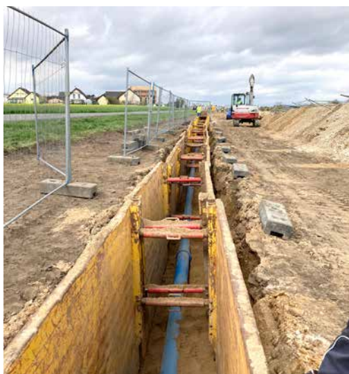
▲ vodovodní přívaděč Chrást - Bezděčín
