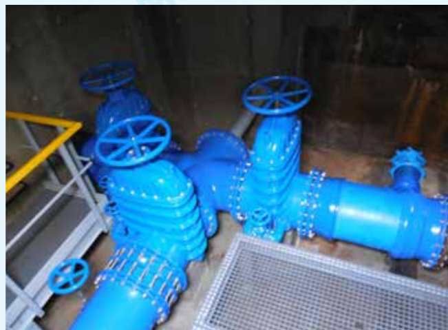
Dobrovice - vodovodní přívaděč, armaturní komora
