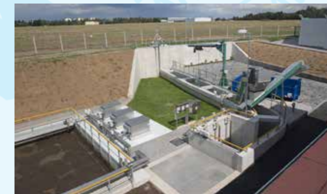
Mnichovo Hradiště ČOV - hrubé předčištění
