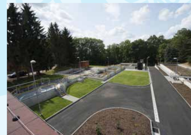
Mníchovo Hradiště ČOV - biologická linka
