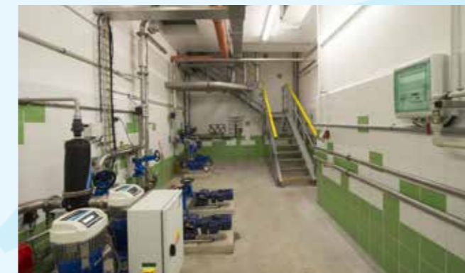
Mnichovo Hradiště ČOV - strojovna kalového hospodářství
