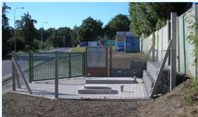
Kosmonosy, čerpací stanice odpadních vod I
