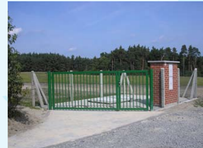
Bělá - Šestidomí, čerpací stanice odpadních vod
