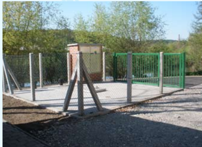
Debř - Josefodolská, čerpací stanice odp. vod
