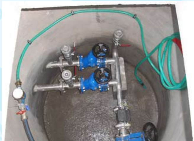
Kosmonosy, armaturní šachta čerpací stanice I
