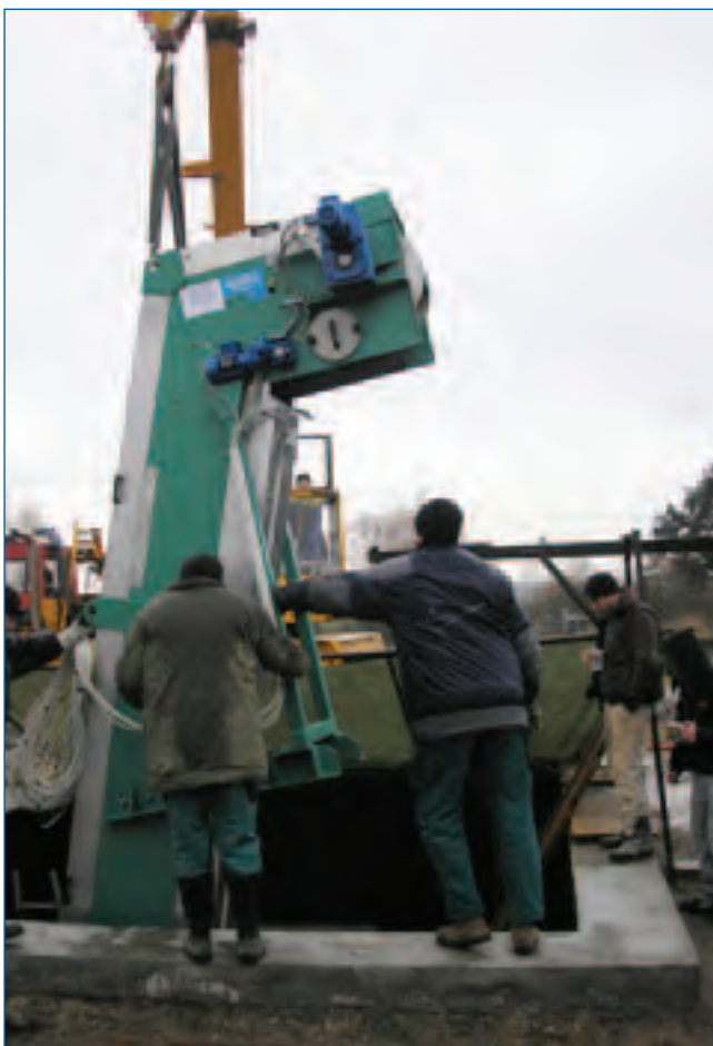
Strojně stírané česle ČOV Luštěnice – Zelená
