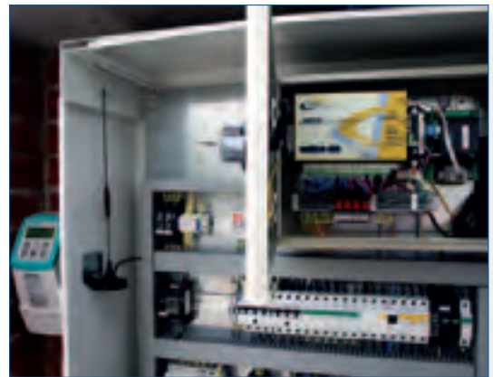
Rozvaděč s řídicí jednotkou na čerpací stanici
