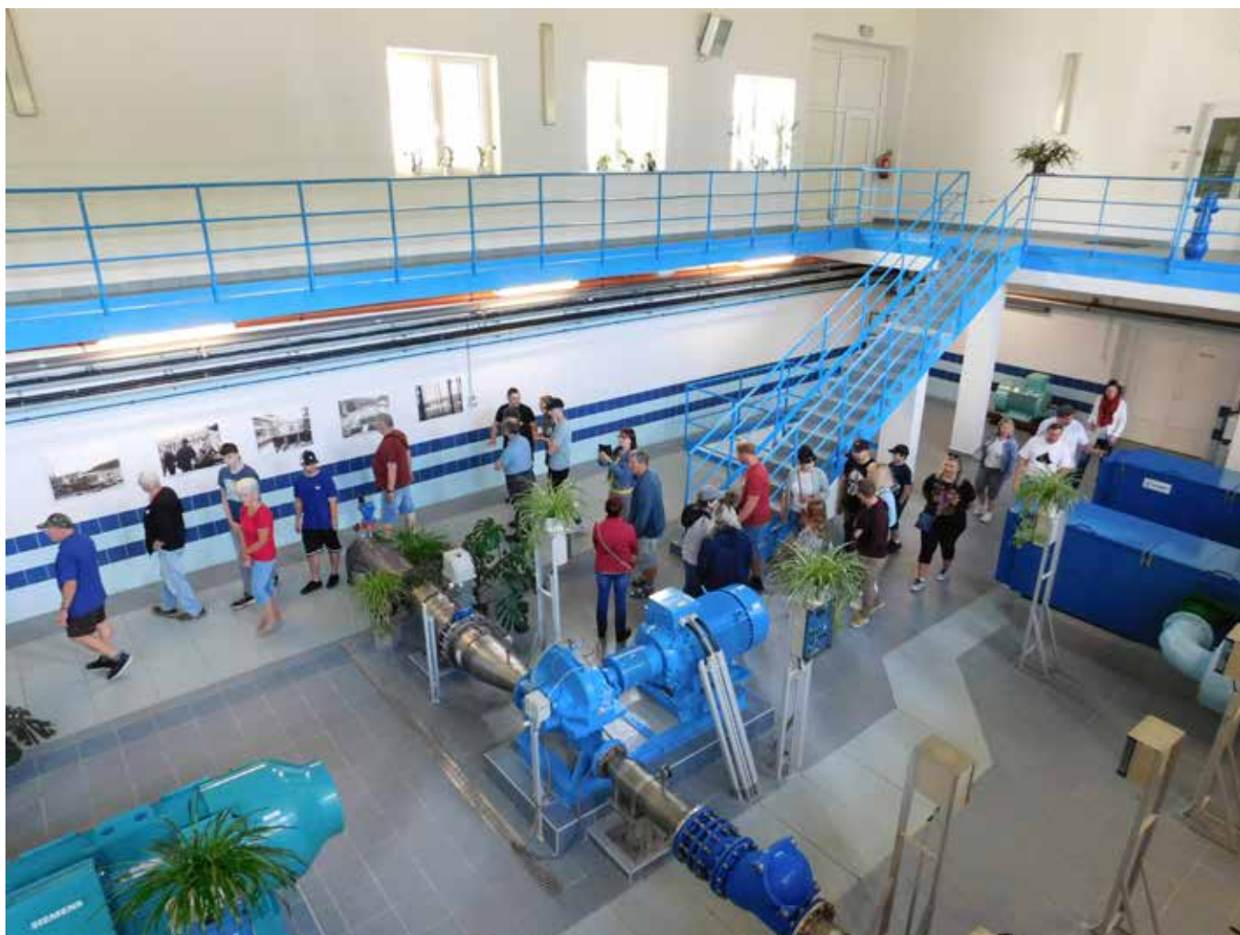
Rečkov – úpravna vody
