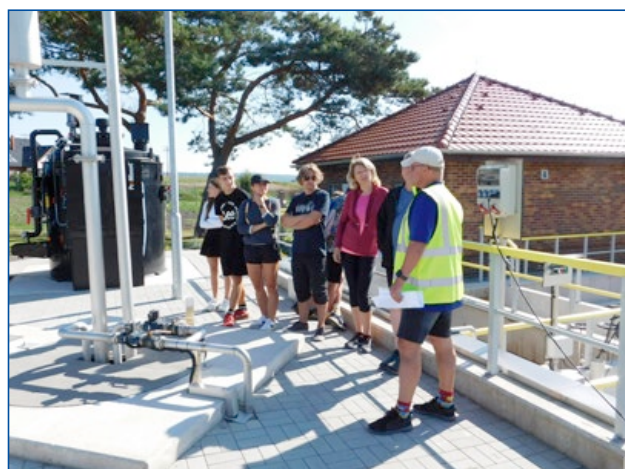
Semčice, čistírna odpadních vod
