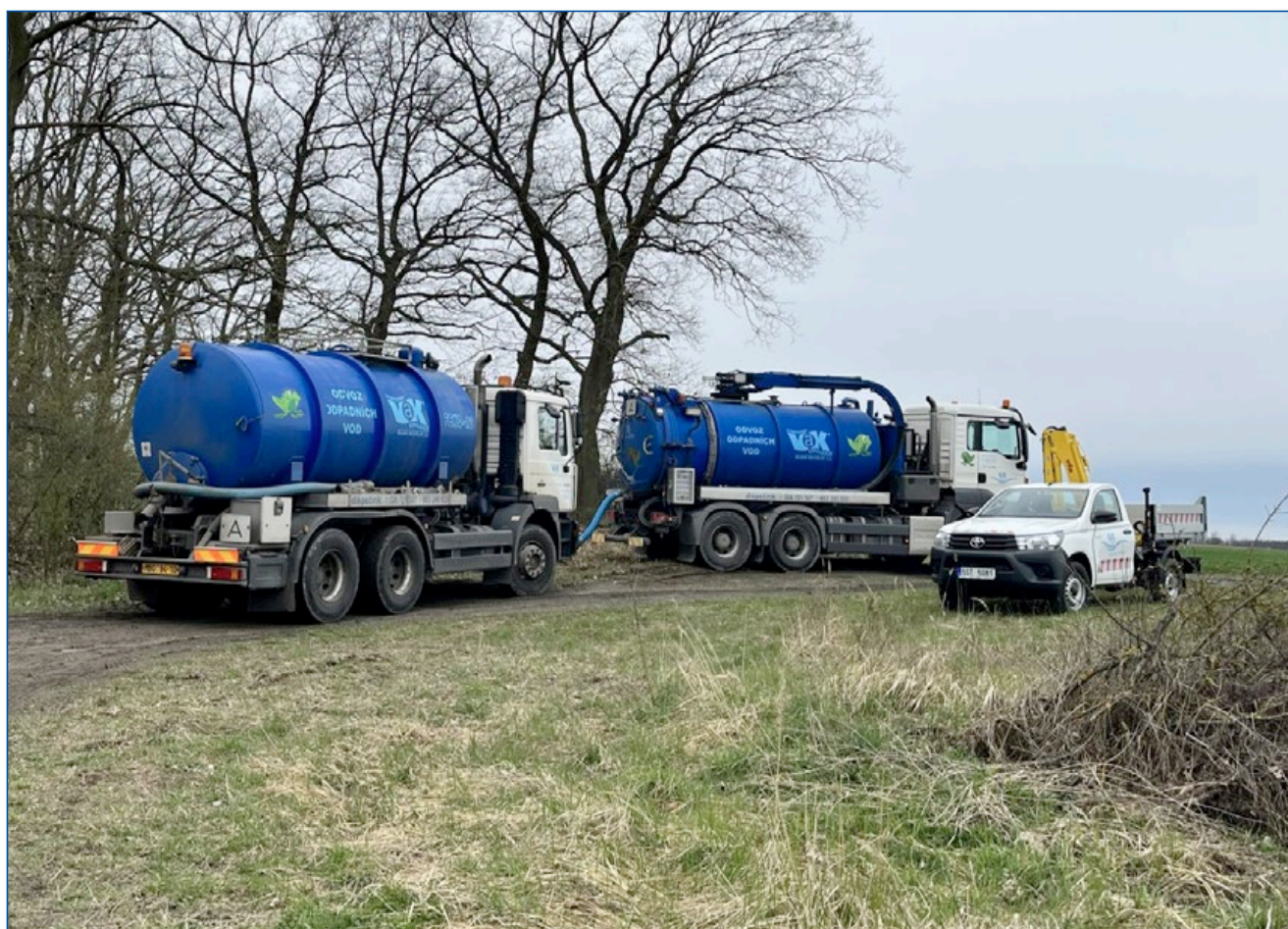
Jiřice, čerpací stanice odpadních vod – nouzový odvoz odpadních vod
