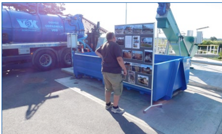
Semčice, čistírna odpadních vod
