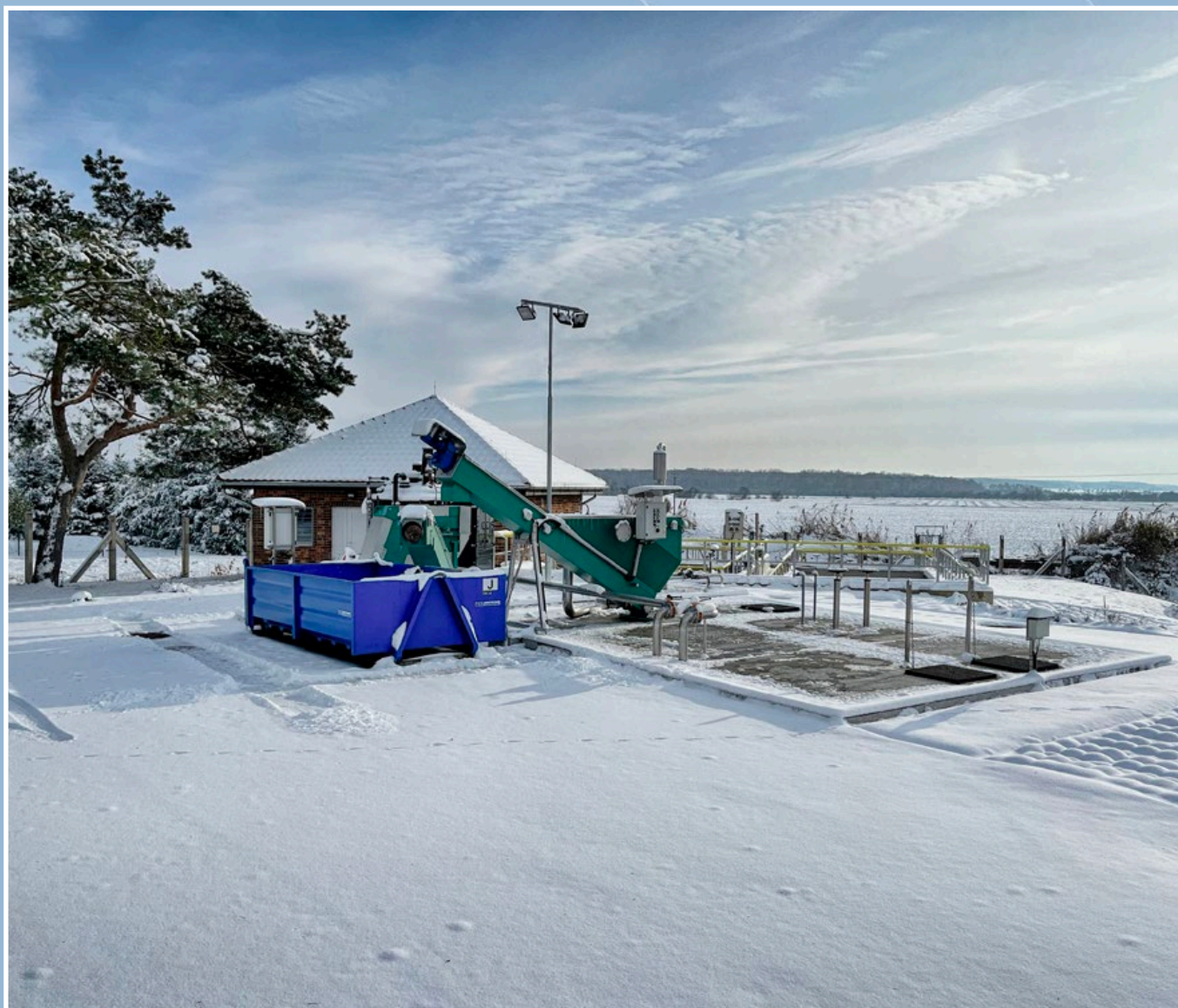
Semčice – čistírna odpadních vod
