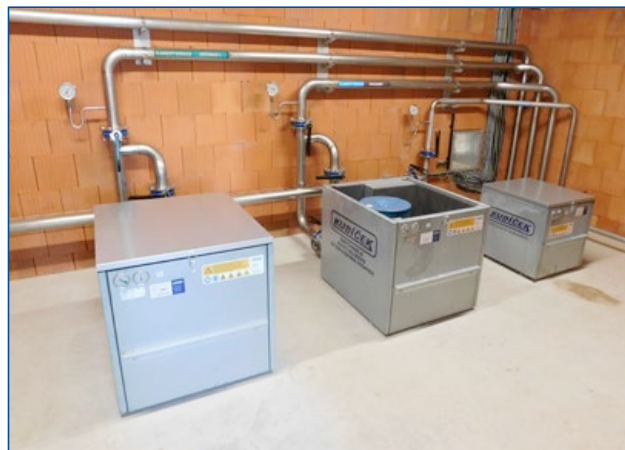
Semčice, čistírna odpadních vod
