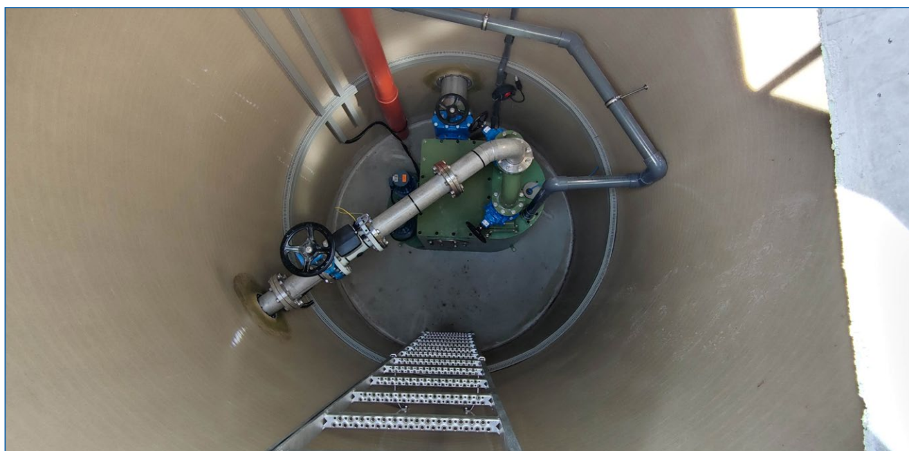
Hrdlořezy, čerpací stanice odpadních vod 2 – interiér
