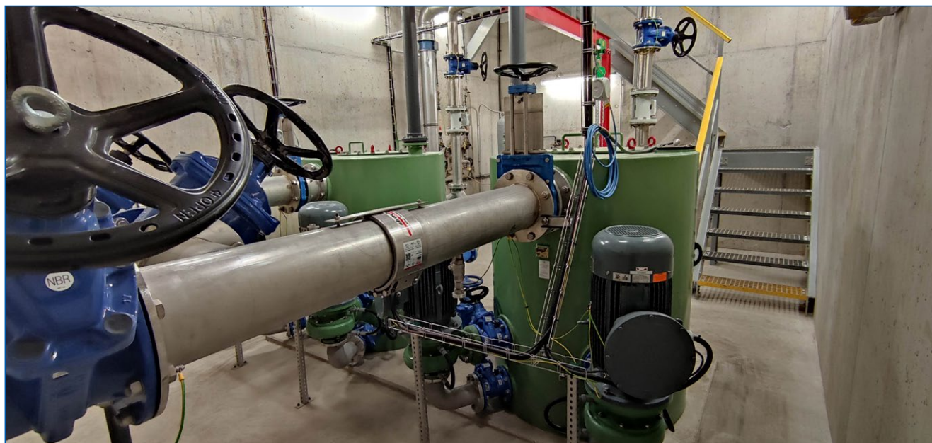
Brodce, hlavní čerpací stanice odpadních vod – interiér
