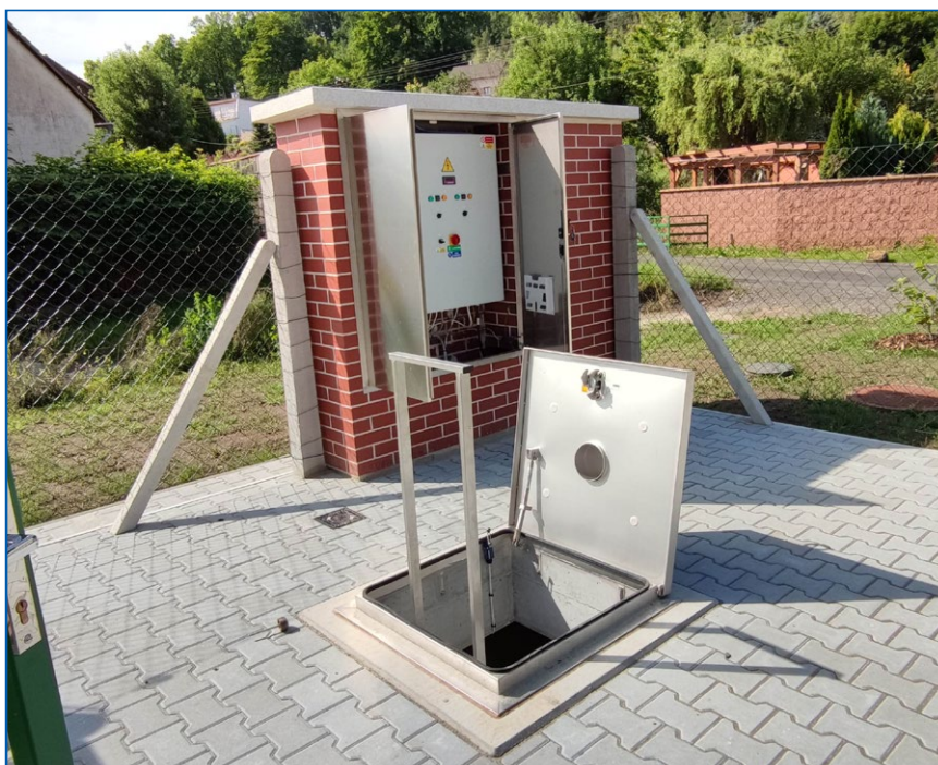
Hrdlořezy, čerpací stanice odpadních vod 2
