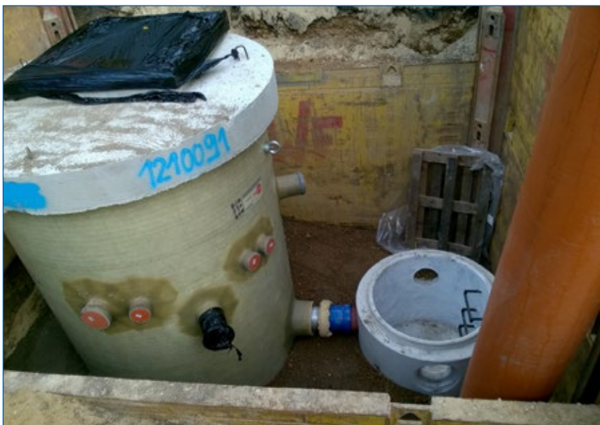
Hrdlořezy - instalace ČSOV 2
