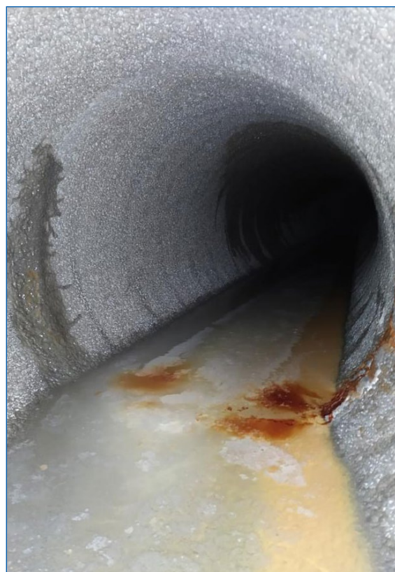
Bradlec, areál zemních vodojemů – trhlina v potrubí DN 600 mm
