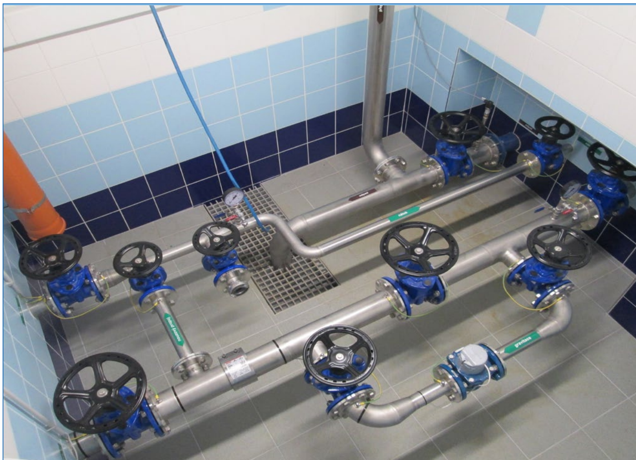
Vystrojení armaturní komory, realizováno vlastními silami
