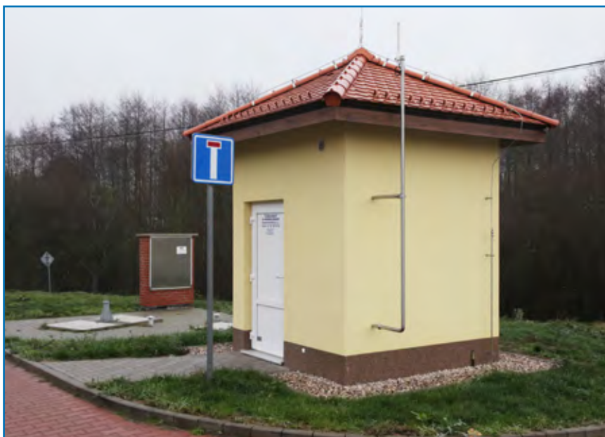
Kněžmostě, automatická tlaková stanice
