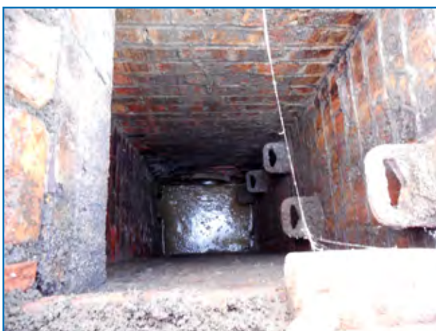
Šachta před sanací
