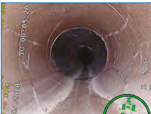
Stoka před sanací
