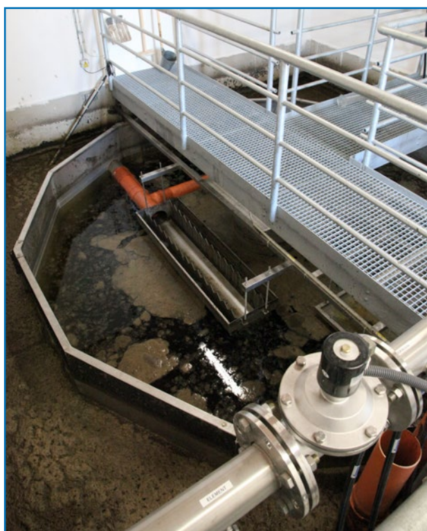
Kosořice, ČOV - interiér s technologií
