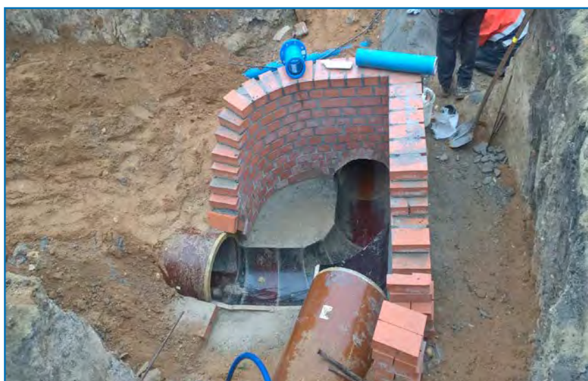
Dobrovice, ulice Husova a Fučíkova – atypická kanalizační šachta
