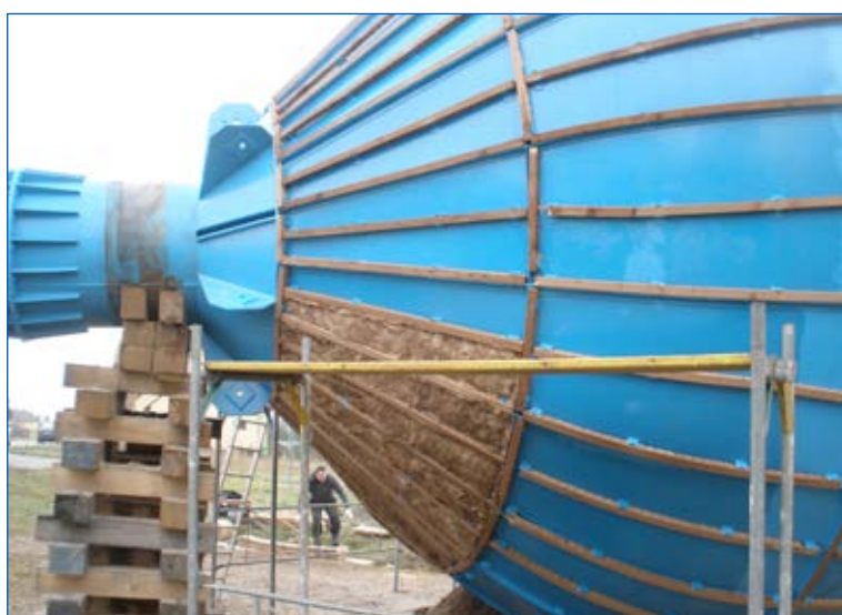
Po základním a finálním nátěru byla s výplní tepelné izolace provedena montáž dřevěné nosné konstrukce opláštění s výplní tepelné izolace. Následně byla provedena montáž opláštění nádrže vodojemu.
