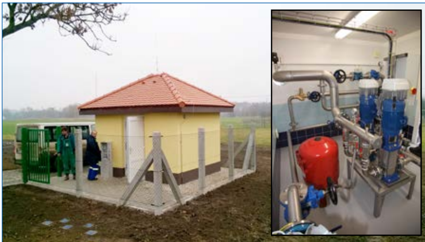
Koprník, přečerpávací stanice - řešení kvality pitné vody na Kněžmostsku
