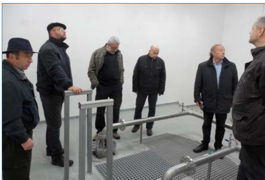
Benátky nad Jizerou, čerpací stanice I
