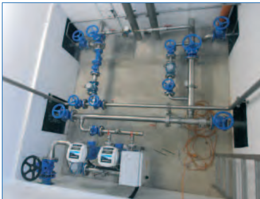
Boseň, připojení na vodovod Mn. Hradiště, umístění čerpadel ve vodojemu Dneboh
