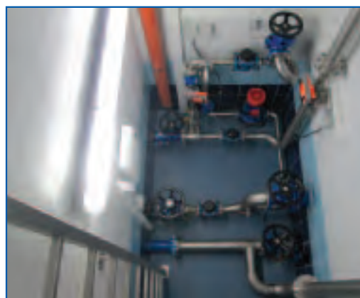
Malá Bělá, rekonstrukce vodojemu, technologie
