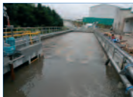
Mnichovo Hradiště ČOV, provoz první poloviny aktivace po rekonstrukci
