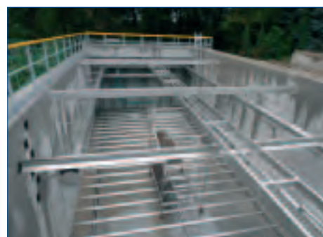
Mnichovo Hradiště ČOV, dosazovací nádrž po rekonstrukci před uvedením do provozu
