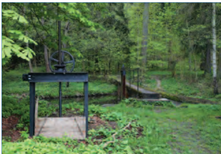
Buřínsko – stavidlo přírodního krytého kanálu
