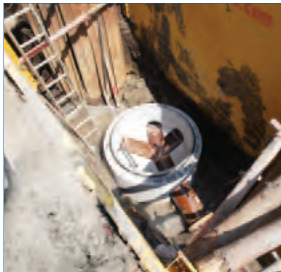
Dobrovice, kanalizace – šachtové dno
