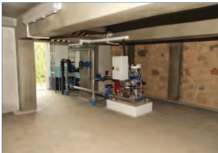
Nemyslovice, vodojem – tlaková stanice
