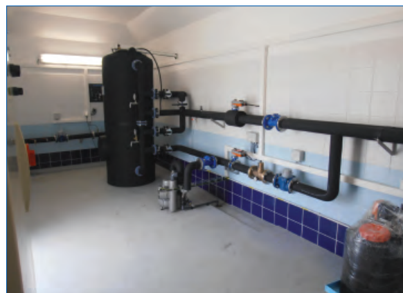
Chotětov, technologie úpravny vody
