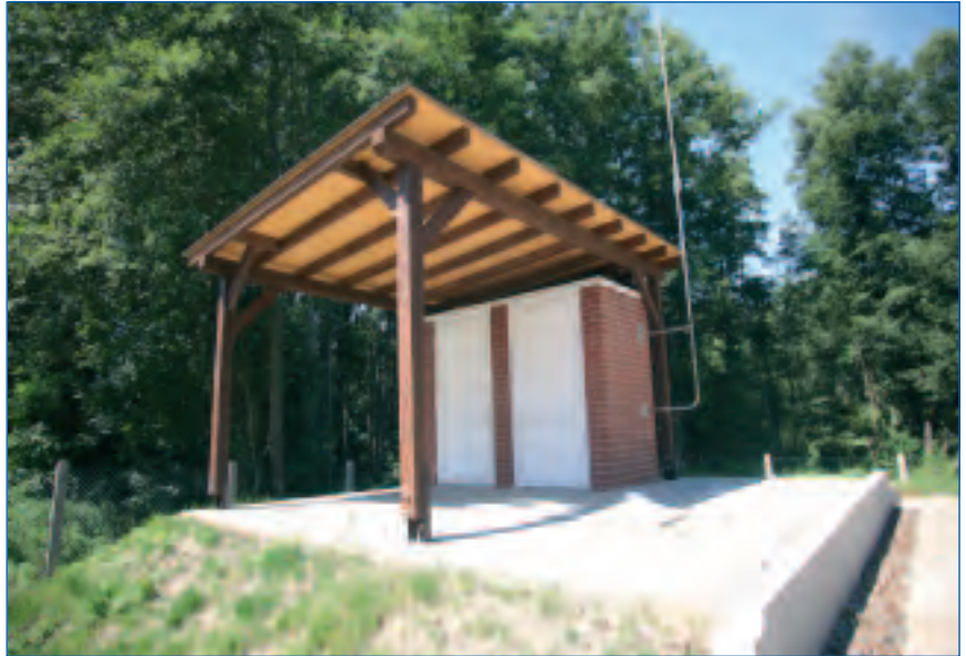
Nová čerpací stanice se zdrojem
