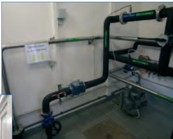
Pískové Lhota - interiér úpravný vody
