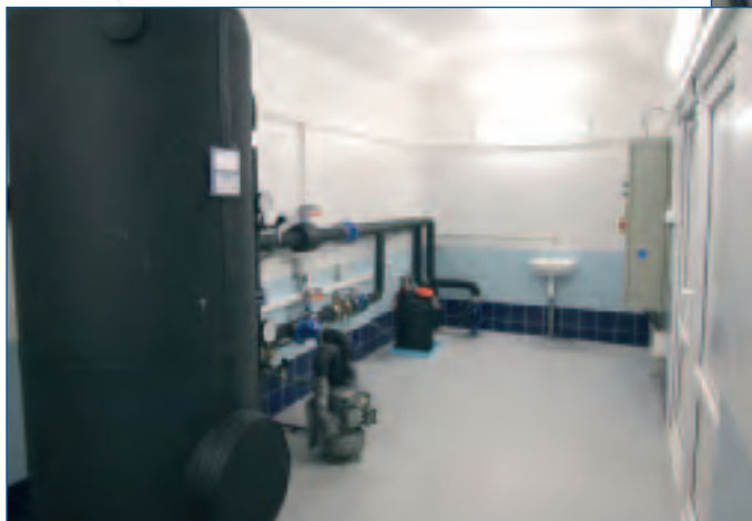
Chotětov - interiér úpravný vody
